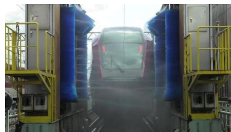
車体洗浄装置
